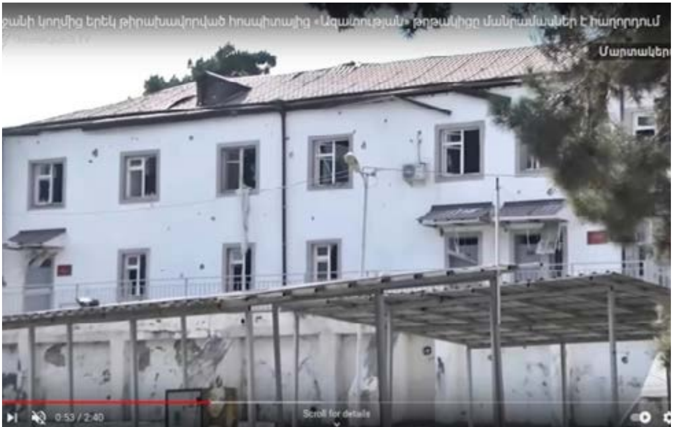
Պատկեր 15.6. Մարտակերտի զինվորական հոսպիտալի հիմնական մասնաշենքին հասցված վնասը, 14 հոկտեմբերի, 2020թ.: (Աղբյուրը՝ «Ազատություն Թիվի»):
